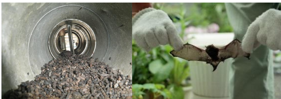
換気ダクト内の糞
